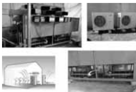
写真7 ヒートポンプ
