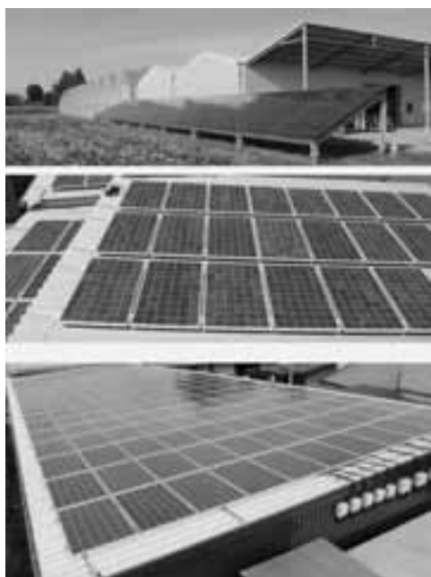
写真6 地上型の太陽光発電設備(上) (10.35kW)、 屋上型の太陽光発電(中) (29.4kW)、事務所 上の太陽光発電設備(下) (53.9kW)
